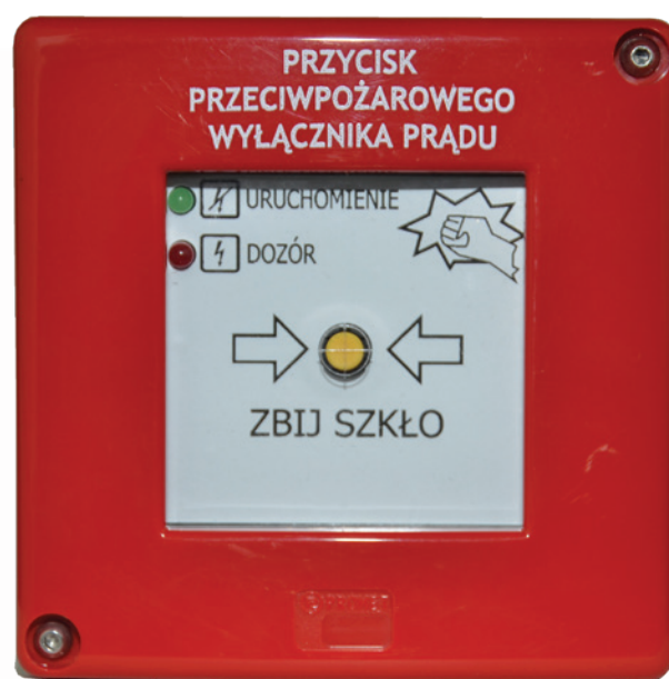
Przycisk przeciwpożarowego wyłącznika prądu PPWP
